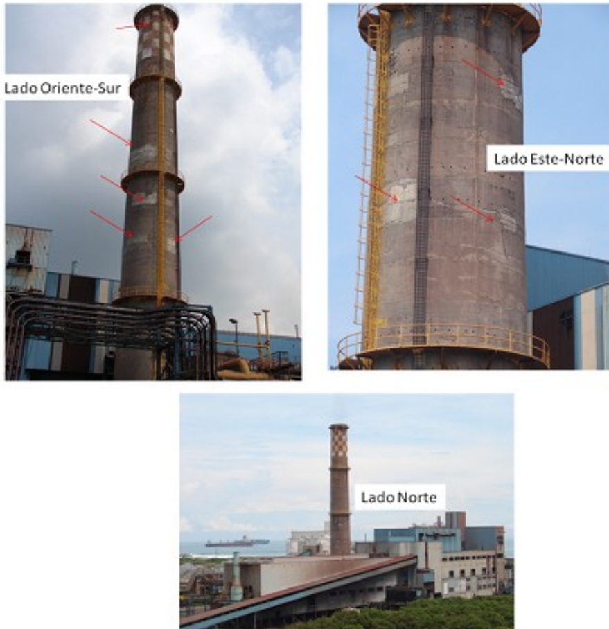
Figura 5. Chimenea de la planta de Peletizado. Deterioros generales (en función de los puntos cardinales)
