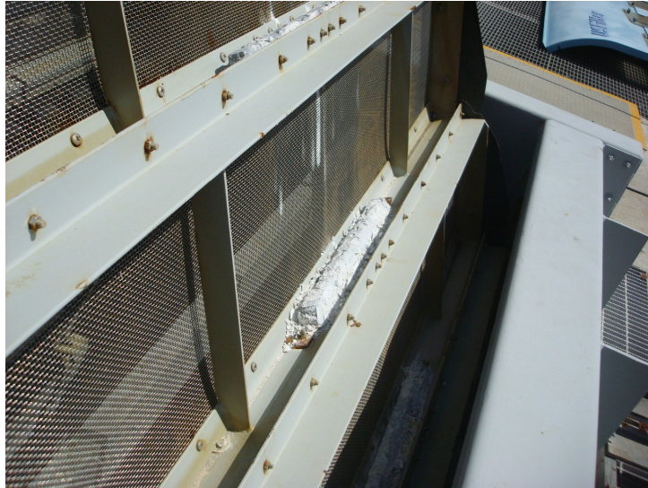
Figura 9. Protección catódica por medio de ánodos de sacrificio que ha sido instalada para proteger de la corrosión a los filtros de agua de mara utilizada en los vaporizadores de una planta de regasificación de gas natural licuado
