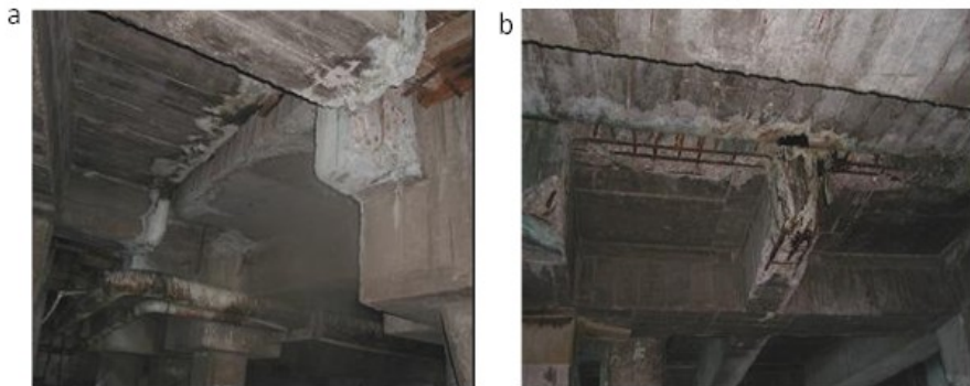
Figura 13. a) Muestra filtración de agua y b) acero expuesto hallados en el puerto A
