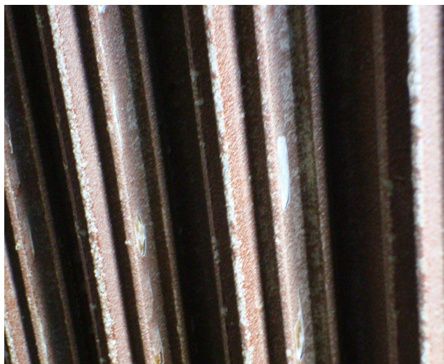
Figura 8. Corrosión en y depósitos en tubos de aluminio de un vaporizador de gas natural licuado expuesto a agua de mar por la cara exterior
