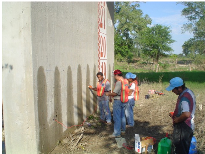
Figura 7. Muestra la medición de potencial de corrosión
