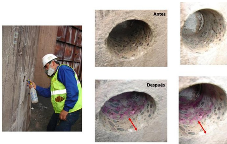
Figura 13. Aplicación de Fenolftaleína en la Chimenea de la planta de Peletizado, Nivel 1.20 m, y resultados de la pérdida de alcalinidad de la estructura
