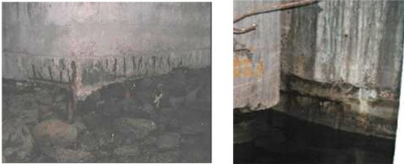
Figura 14. Muestra daños en interior del muelle (Puerto A)
