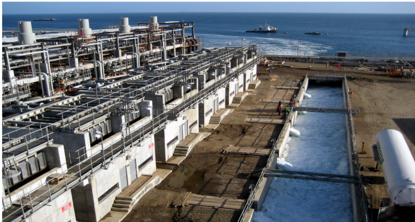
Figura 7. Vista general de una instalación típica de vaporizadores de gas natural licuado
