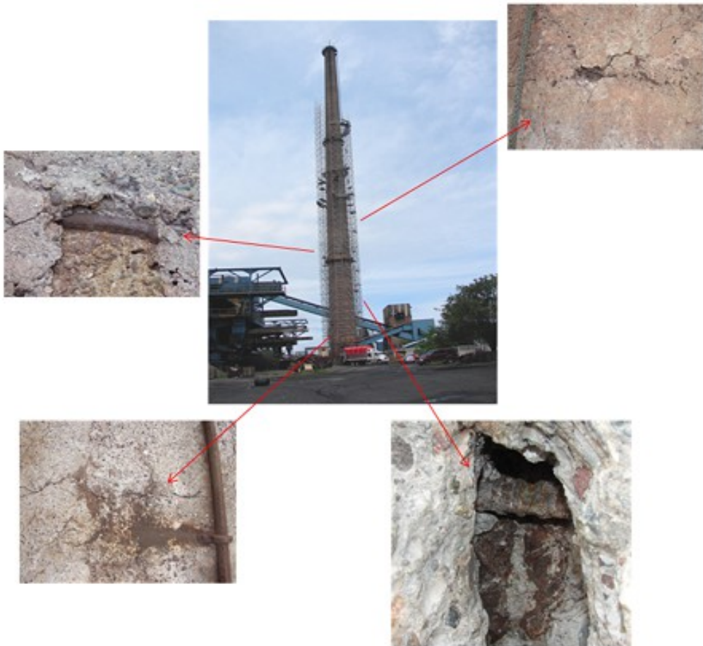
Figura 6. Deterioros en la Chimenea de la Planta Coquizadora
