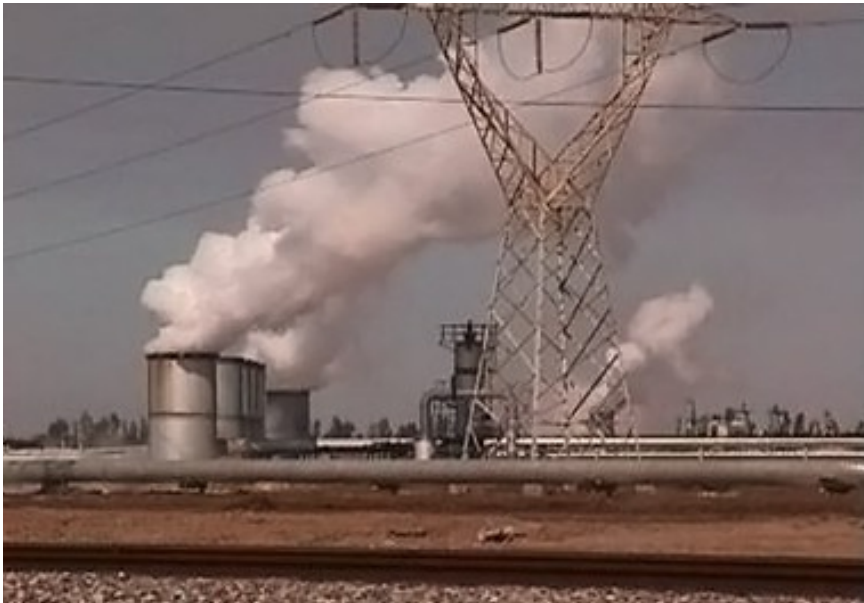
Figura 4. Efectos de la corrosión en instalaciones de producción y conducción de fluido geotérmico y sistemas de transmisión de energía eléctrica
