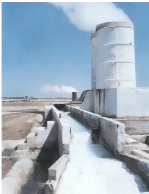
Figura 3. Instalación típica de sistema silenciador para la disminución de ruido. También se puede observar el canal de conducción de agua separada
