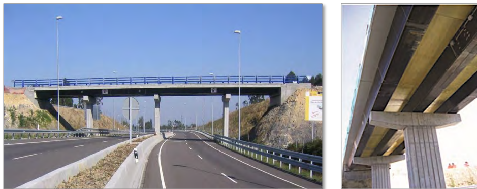
Figura 9.4: Estructura híbrida de un puente de carretera en Asturias, España (por cortesía de Acciona Infraestructuras) [4].
