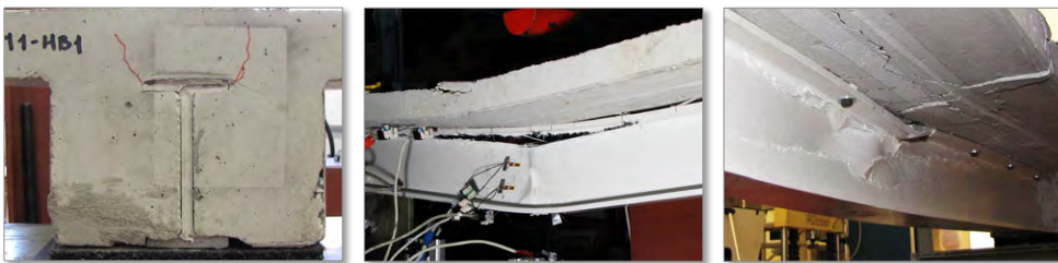
Figura 9.12: Área de fallo de la viga híbrida M1-HB1 (izquierda), fallo a cortante de la viga híbrida M2-HB1 (centro) y fallo por aplastamiento del alma de la viga híbrida M2-HB2 (derecha).
