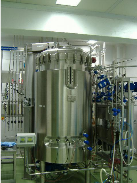
Figura 3: Vista del Fermentador.
